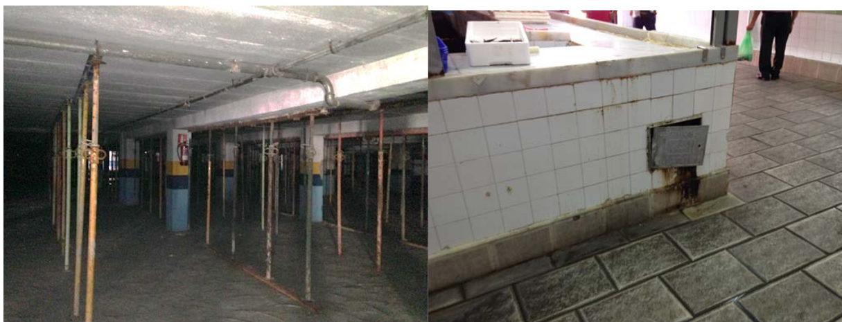
Deterioro de equipamiento e instalaciones
