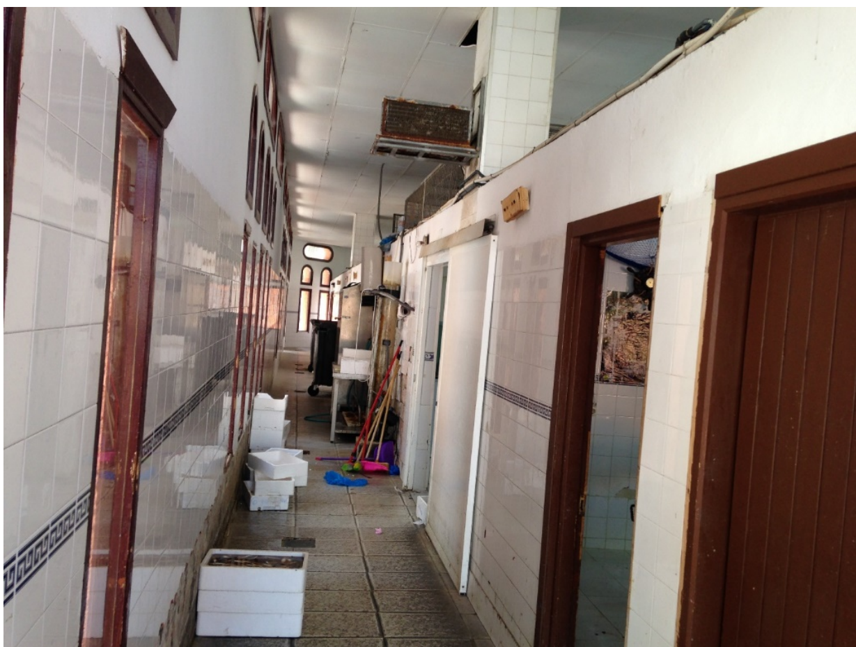
Vista de un pasillo de servicio con compresor de cámara.
