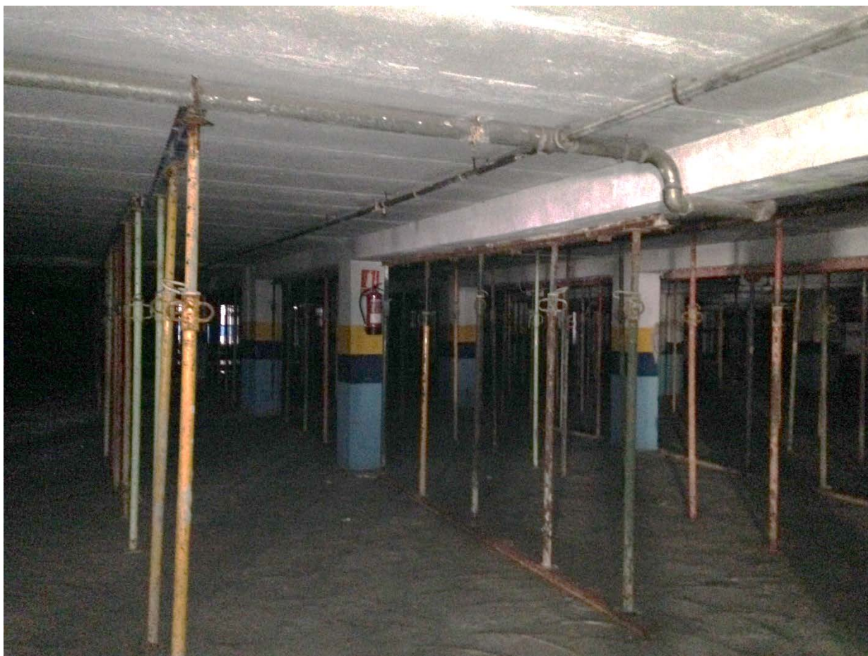
Área apuntalada en sótano 1 desde 2012.
