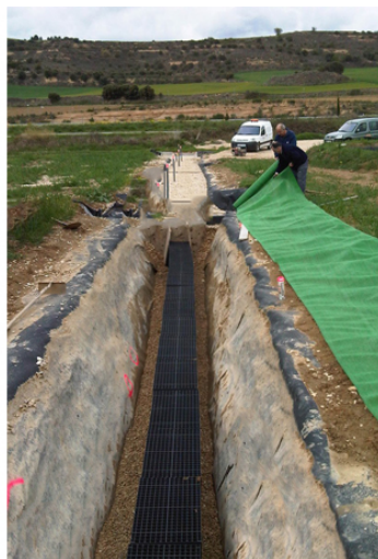
Celda de infiltración (izq) y zanja filtrante hecha con módulos de infiltración (dcha)
