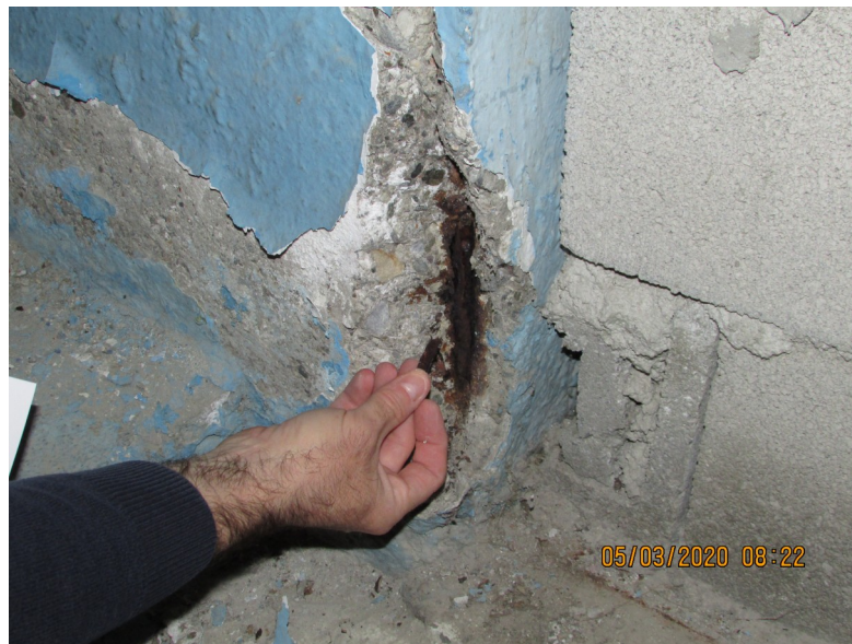
Afección en base del pilar junto al acceso de garaje por calle Sánchez Chaves.
