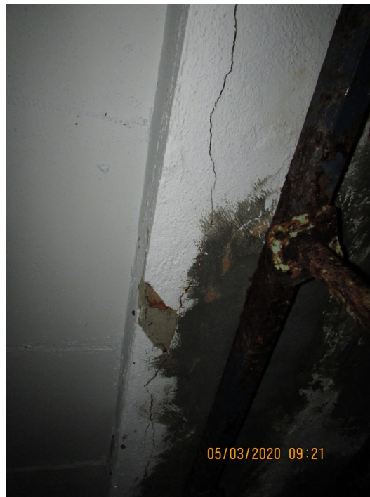
Muestra de afecciones de soportes y jácenas en planta -2
