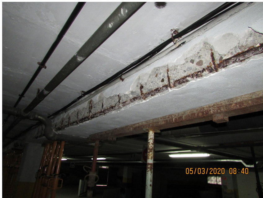
Estado de las jácenas de techo de planta -1 en la zona bajo puestos del pescado con patologías más severas.
