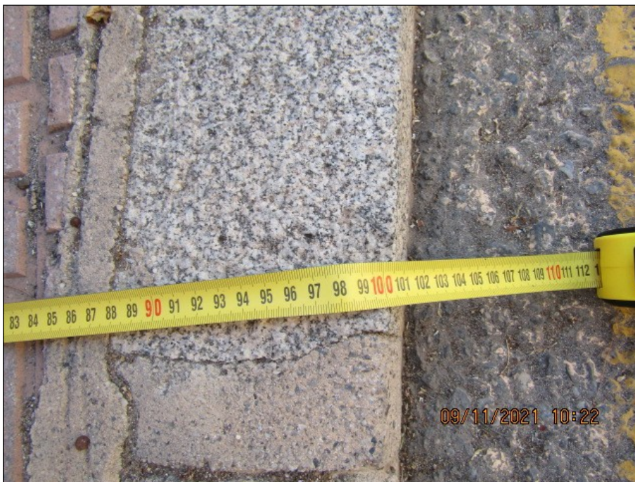
Foto4. Ancho estricto del acerado: 1,00 m
