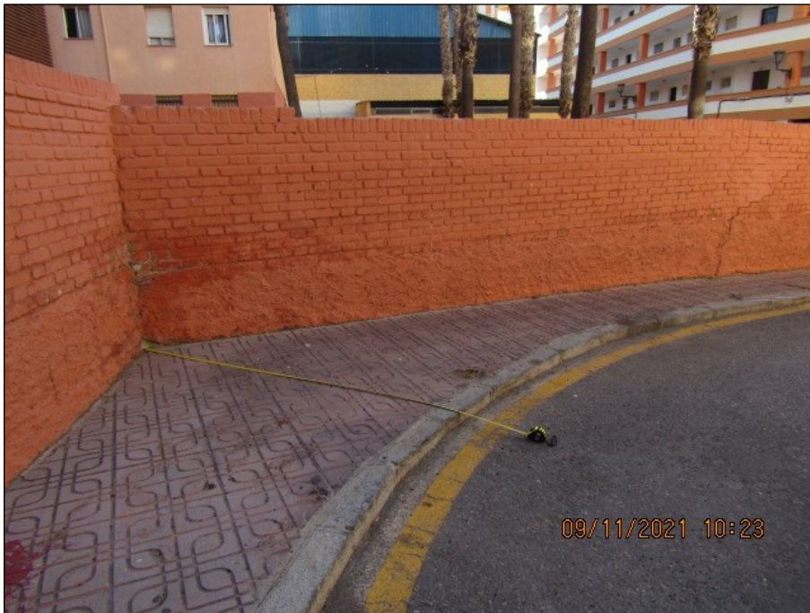
Foto 5. Medición del ancho del acerado en el punto singular del cambio de alineación del muro
