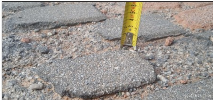
Foto5. Resaltos generados por la descomposición de los adoquines. Inferiores a 1 cm.
