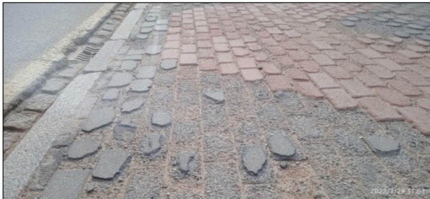
Foto 7. Vista localizada de la zona indicada por la interesada, desde acerado hacia el Este. Deterioro generalizado de la superficie del pavimento por descomposición del adoquín.
