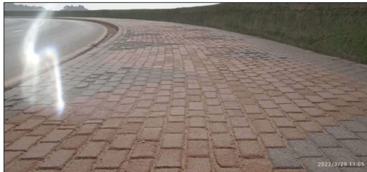
Foto1. Vista general del estado del pavimento en la zona afectada.
