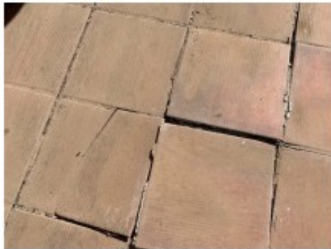
Baldosas levantadas del paño
