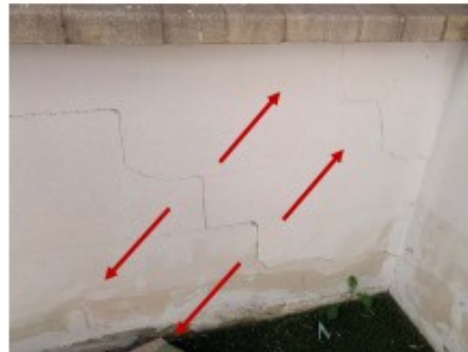
Detalle de la otra fisura reclamada, por vuelco del muro hacia el exterior. Imposible que sean causadas por empuje vertical de las raíces desde el suelo
