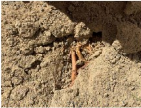
Raíces que provocan el levantamiento de la solería
