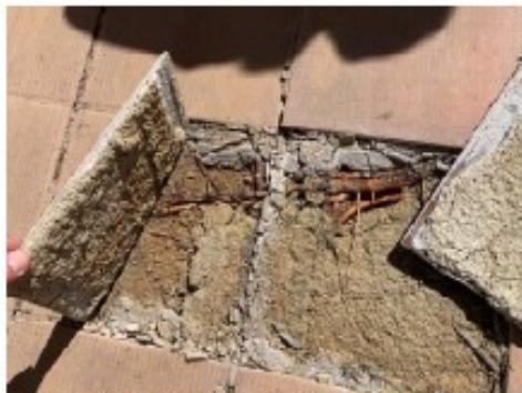
Tras levantar las baldosas, se observan las raíces de la palmera
