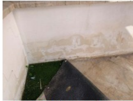
Humedades en parte inferior de muro por filtraciones, no achacables a las raíces
