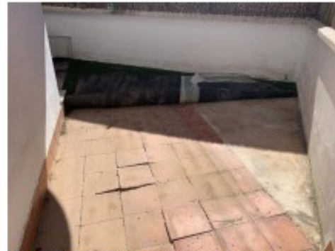
Otra vista de las baldosas levantadas. Se observa igualmente que existe una zona sin solar, de 6 m 2
