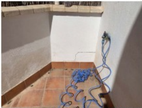
Figura en muro perimetral, por vuelco del muro hacia el exterior
