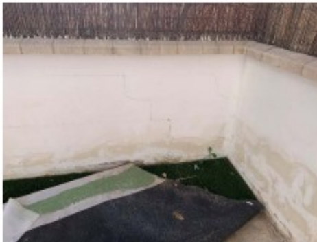
Muro opuesto, con fisura similar y en el mismo sentido que la anterior.
