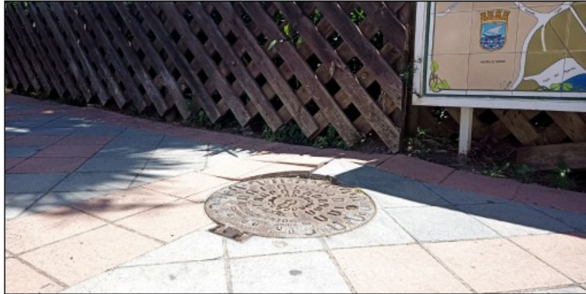
Foto1. Pavimento levantado en las proximidades del seto perimetral del Parque
