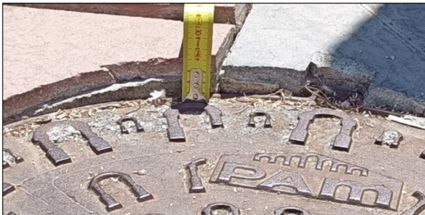
Foto2. Desnivel entre la tapa del pozo de registro y la baldosa, de 4 cm
