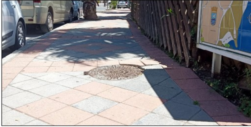
Foto 3. Desnivel transversal y baldosas sueltas entre tapa del pozo de registro y el seto perimetral, sentido ascendente
