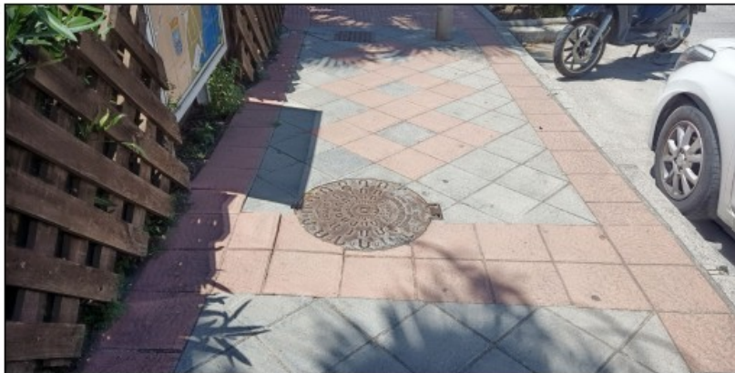
Foto 4. Desnivel transversal y baldosas sueltas entre tapa del pozo de registro y el seto perimetral, sentido descendente
