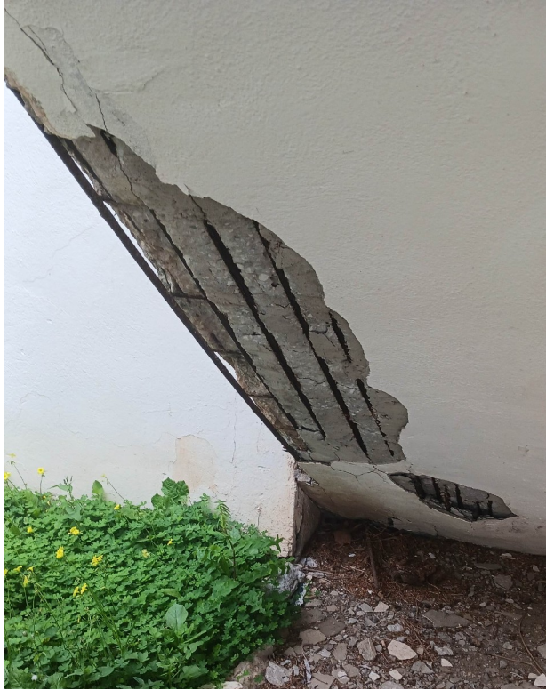
Pérdidas de secciones útiles de los elementos portantes de losas de escaleras de comunicación exterior. Pérdidas de revestimientos exteriores, recubrimientos y oxidaciones de armaduras.
